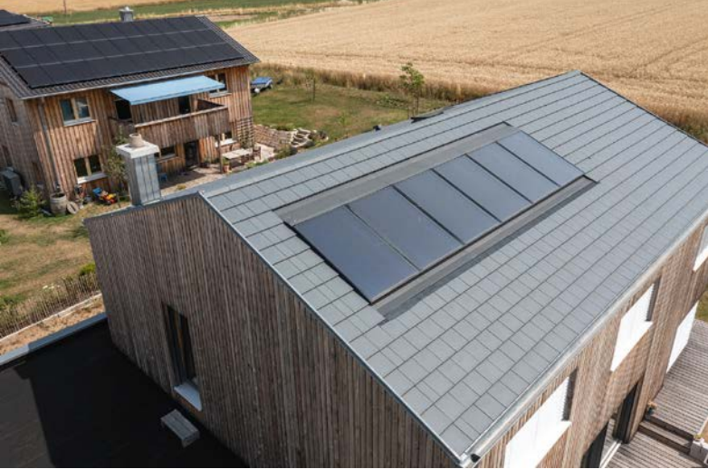
So kann es gehen: Bei diesem Einfamilienhaus ergänzt eine Solarthermieanlage den Pelletkessel mit Pufferspeicher.
